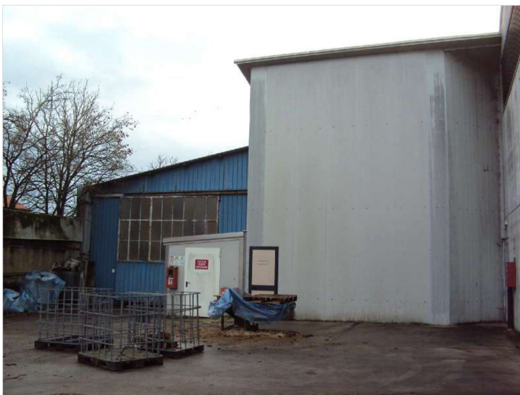
Foto n. 50: Locale impianto antincendio, fabbricato H
