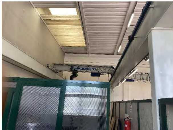
1°-05-GRU ELETTRICA A PONTE 4 TON. c.5,00 ML.
