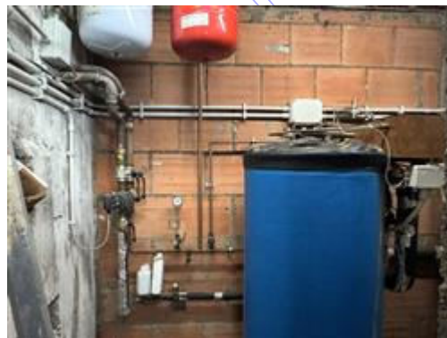
Caldaia non funzionante
