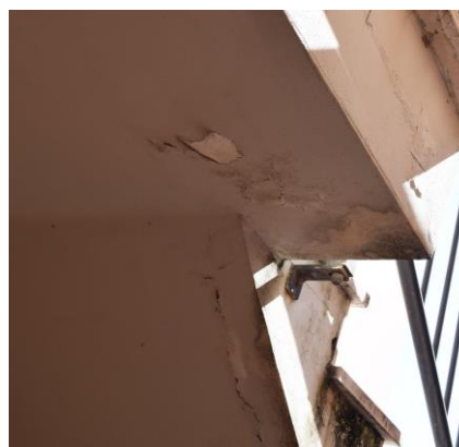
Foto 25: Deterioramento intonaco intradosso scala esterna
