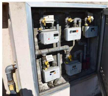
Foto 21: Contatori gas metano (muretto accesso)
