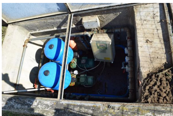
Foto 22: Vano attrezzato pompe acqua potabile da pozzo
