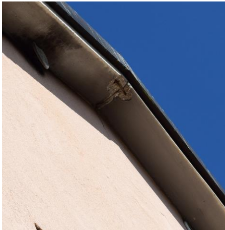
Foto 28: Degrado intonaco copertura
