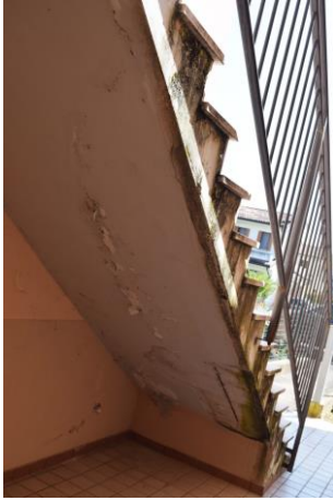
Foto 26: Deterioramento intonaco intradosso scala esterna
