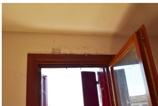
Foto 24: Deterioramento intonaco finestra soggiorno
