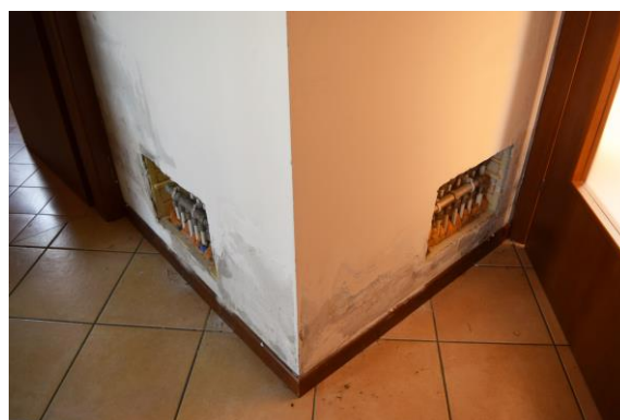
Foto 23: Deterioramento intonaco disimpegno corrispondenza connettori imp. termico
