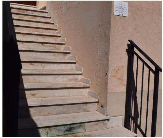
Foto 27: Fessurazioni della rasatura del cappotto
