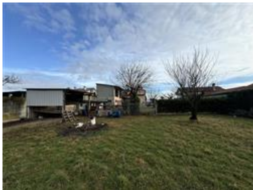
Tettoia abusiva vista Ovest
