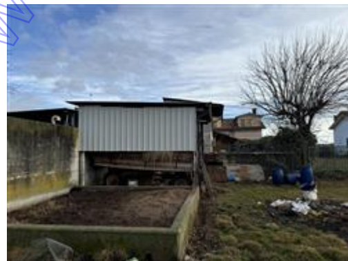
Tettoia abusiva lato Ovest.
