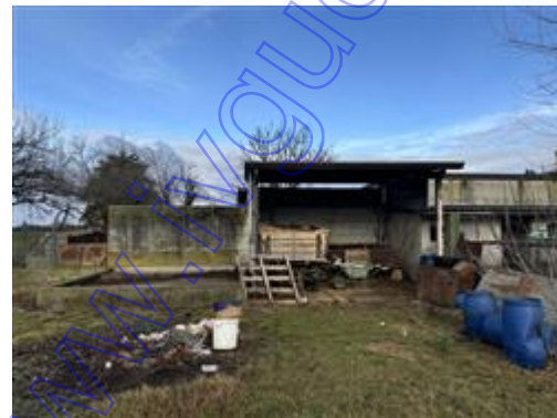
Tettoia abusiva vista Sud
