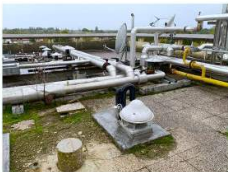
100_terrazza esterna con tubazioni impiantistiche
