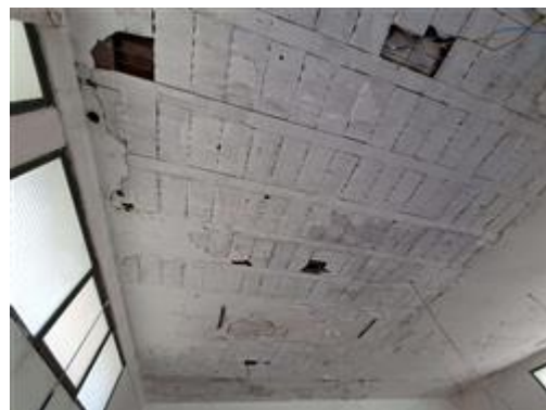
Soffitto ammalorato da infiltrazioni meteoriche
