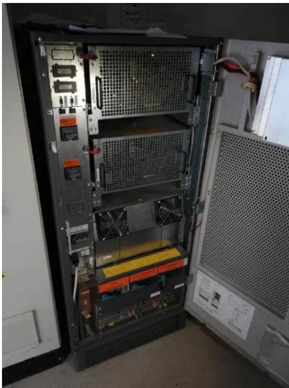
Foto C7: porta aperta convertitori marca SOCOMEC mod. Sunsys Station P03.
