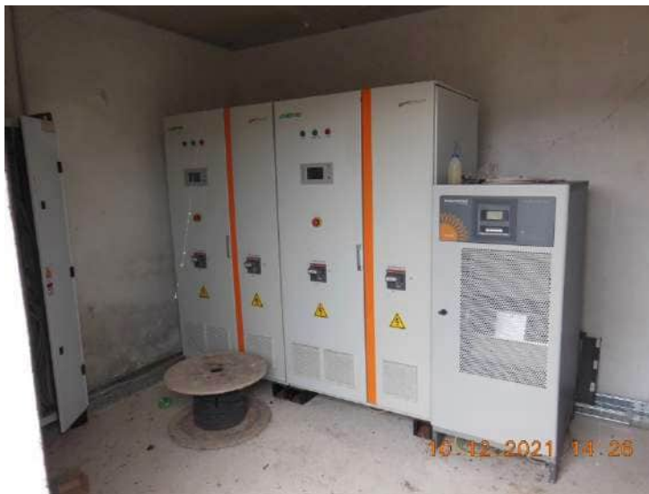
Foto F2: convertitori vari fabbricato n.4.
