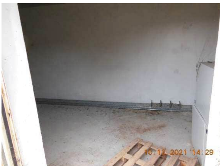
Foto D2: non risultano installati convertitori fotovoltaici nel locale tecnico del fabbricato n.2.
