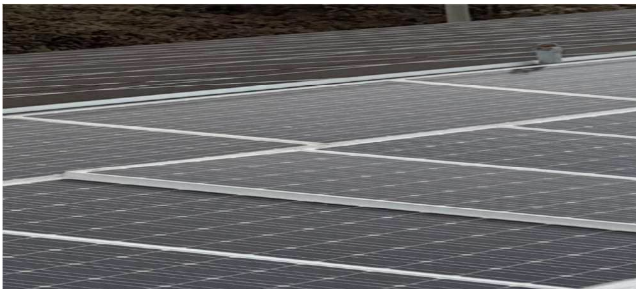
Foto modulo fotovoltaico sganciato dal supporto
