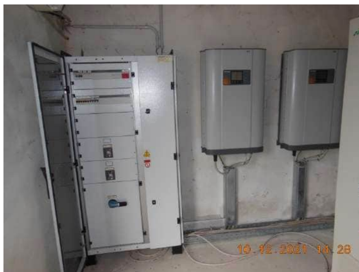
Foto E1: quadro elettrico di bassa tensione.
