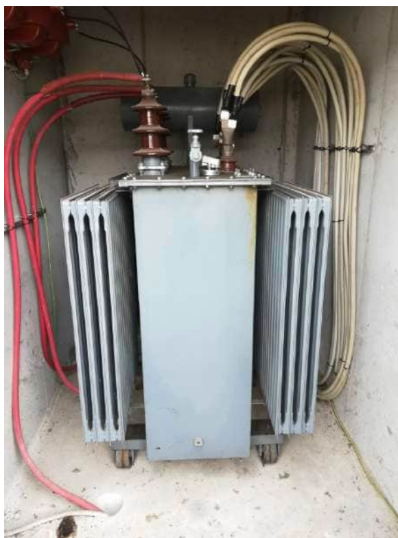
Foto B2: trasformatore trifase.
