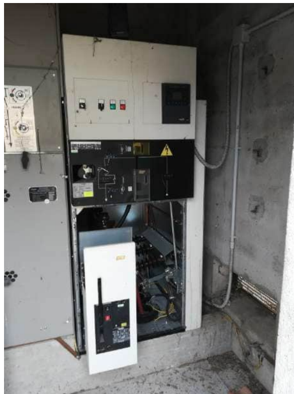
Foto A2: interruttore generale dell'impianto
