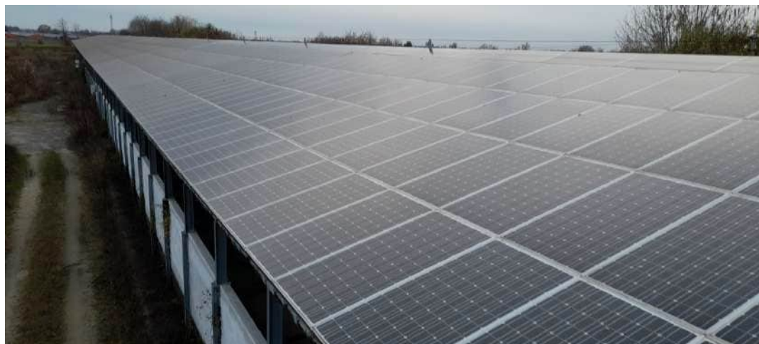
Foto C11: moduli fotovoltaici lato Sud fabbricato n.1.
