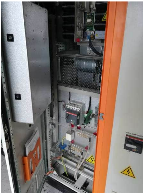
Foto C4: porta aperta convertitori marca SUNGROW mod. SunAccess 100.
