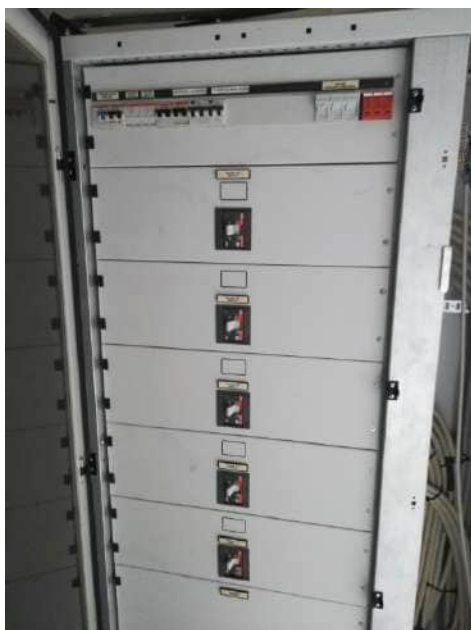
Foto C1: parte superiore quadro elettrico di bassa tensione.
