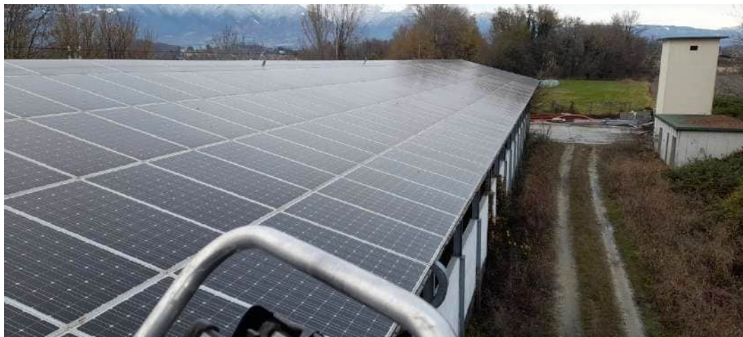
Foto C10: moduli fotovoltaici lato Nord fabbricato n.1.
