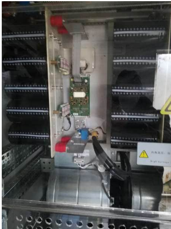
Foto E3: porta aperta convertitore marca SOCOMEC mod. Sunsys Station P03.
