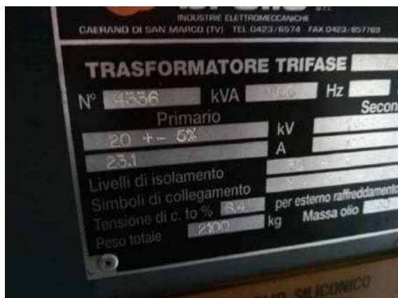
Foto B3: parte sinistra targa trasformatore trifase.
