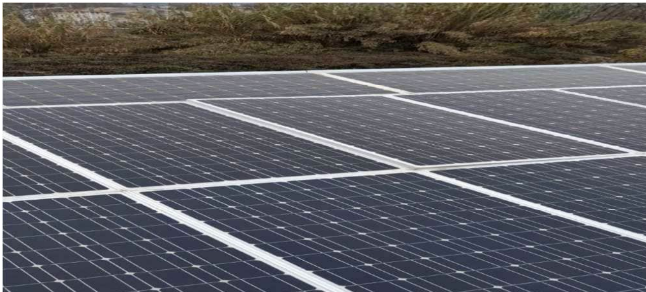
Foto modulo fotovoltaico sganciato dal supporto
