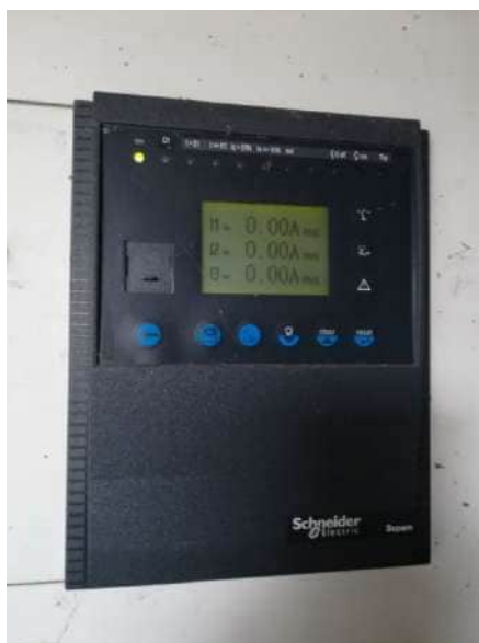
Foto A3: protezione elettronica marca Schneider mod. SEPAM
