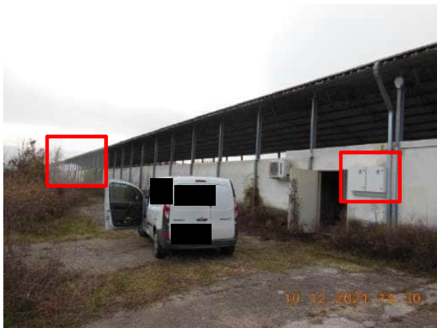
Foto C8: quadri di stringa posizione centrale e Sud fabbricato n.1.
