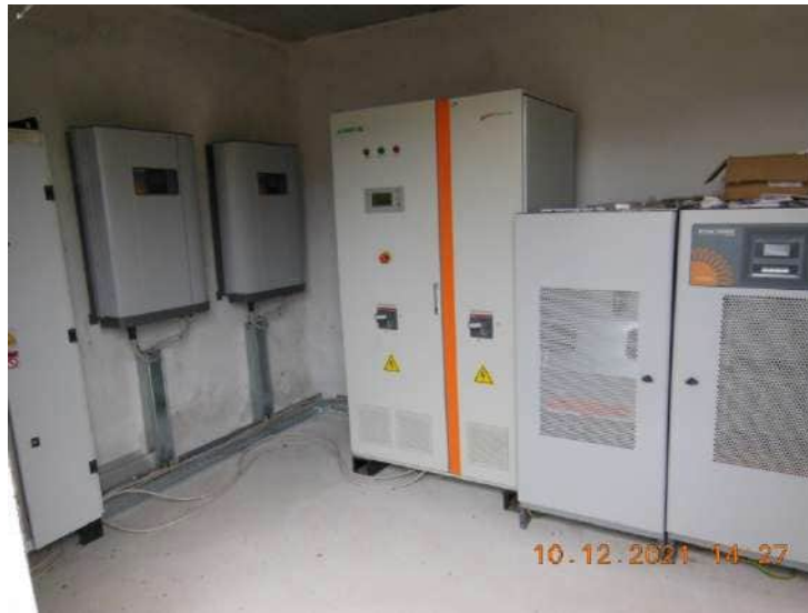
Foto E2: convertitori vari fabbricato n.3.
