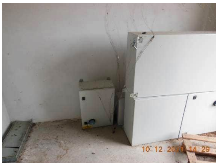
Foto D3: quadri di stringa solo in deposito.
