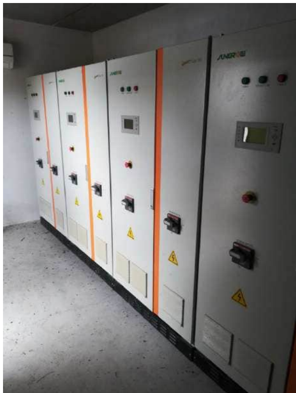
Foto C3: porte chiuse convertitori marca SUNGROW mod. SunAccess 100.
