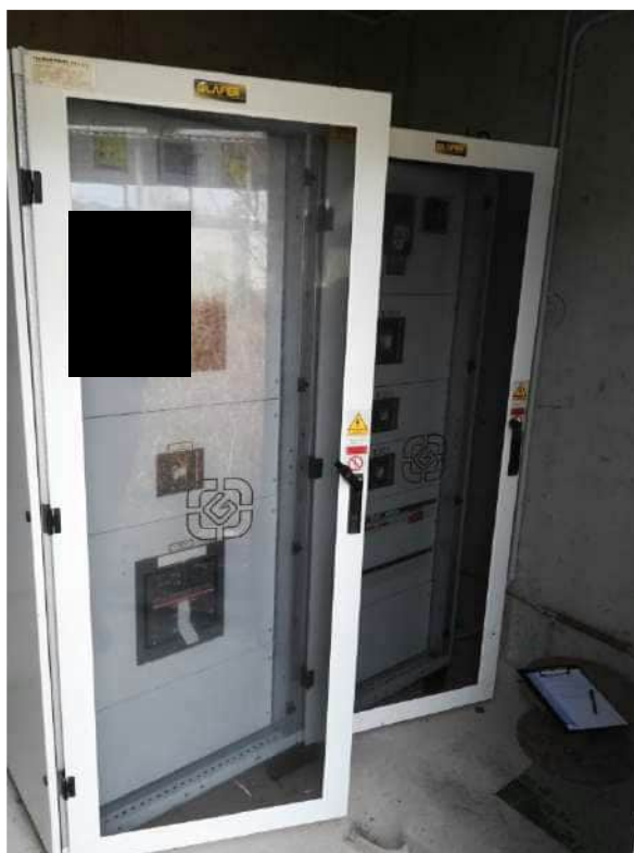
Foto B6: quadro elettrico generale di bassa tensione.
