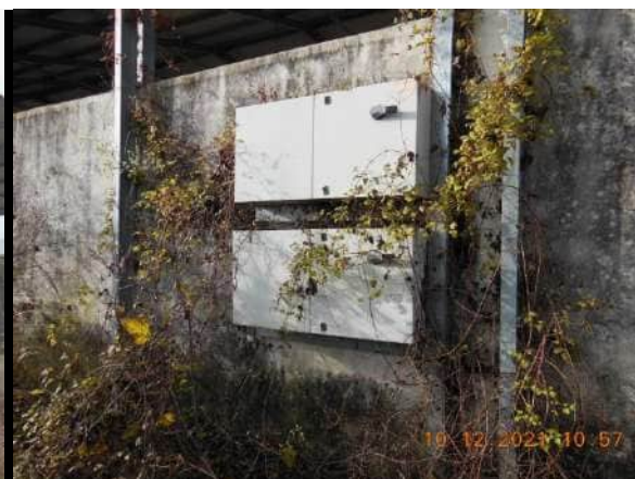
Foto F4: quadri di stringa posizione centrale fabbricato n.4.
