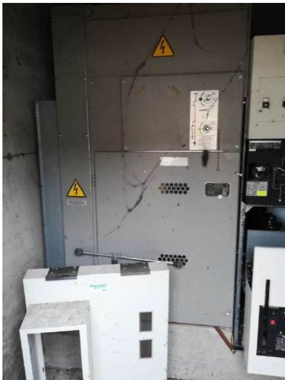
Foto A1: interruttore dell'Ente Distributore.
