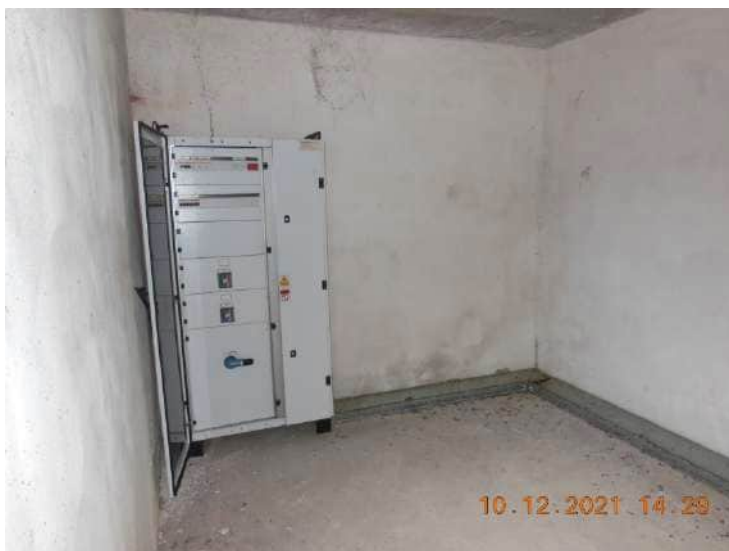
Foto D1: quadro elettrico di bassa tensione.
