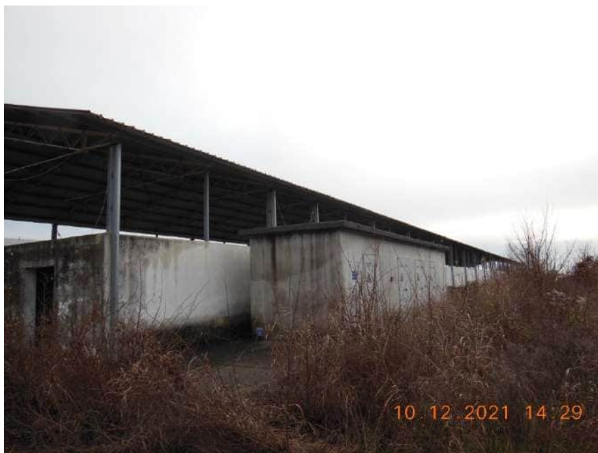
Foto n.2: cabina elettrica di trasformazione impianto fotovoltaico.
