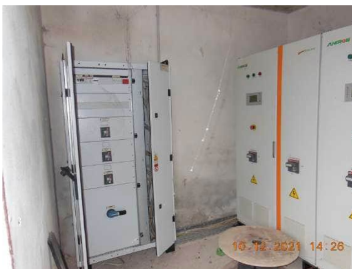
Foto F1: quadro elettrico di bassa tensione.
