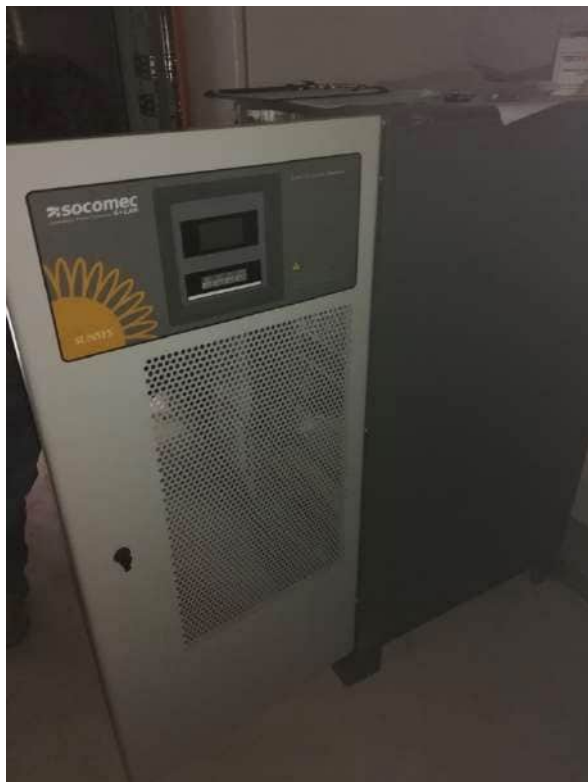
Foto C6: porta chiusa convertitore marca SOCOMEC mod. Sunsys Station P03.
