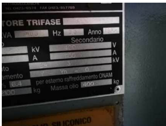
Foto B4: parte destra targa trasformatore trifase.
