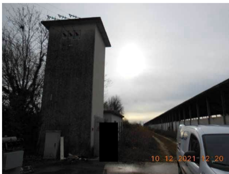
Foto n.3: cabina elettrica a torre 20kV e cabina di trasformazione predisposta.
