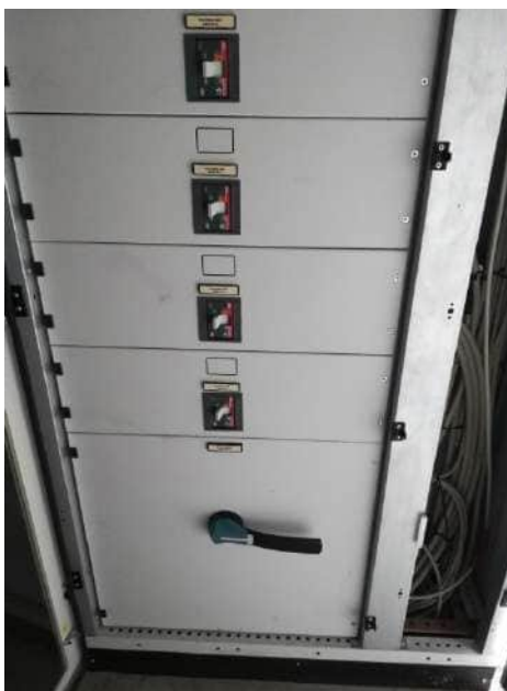
Foto C2: parte inferiore quadro elettrico di bassa tensione.
