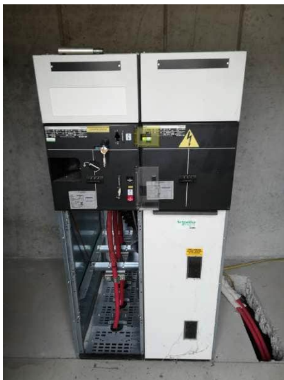
Foto B1: quadro di media tensione.
