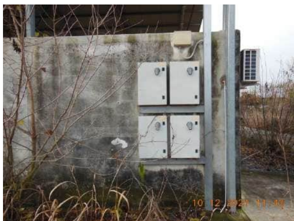
Foto E6: quadri di stringa posizione Nord fabbricato n.3.
