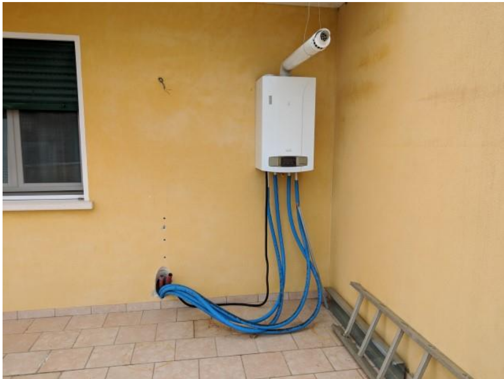
FOTO 29: PARTICOLARE CALDAIA (TERRAZZO AL P.T.)
