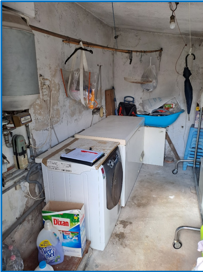
n° 7 - Interni centrale termica
