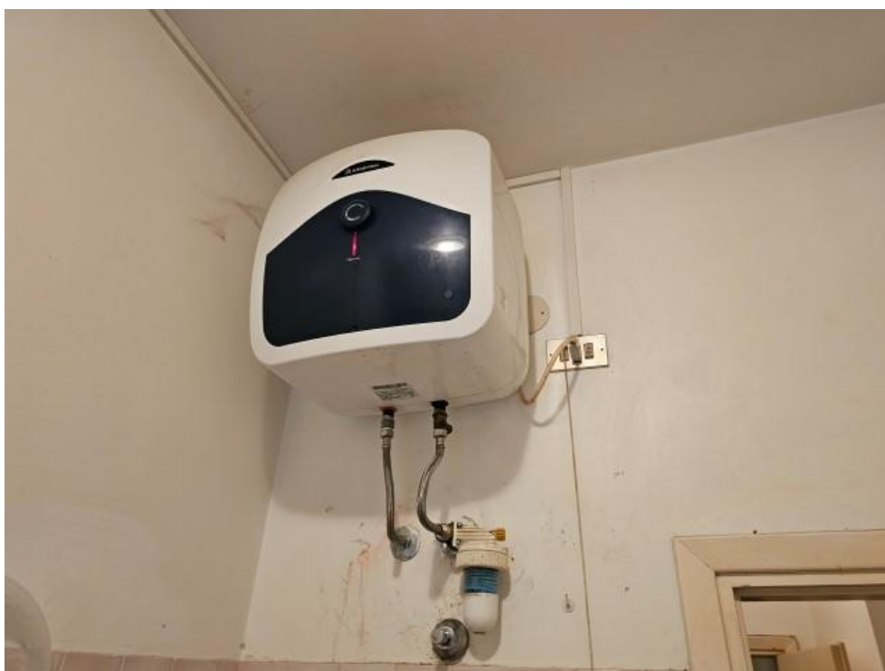
FOTO 20: BOILER ELETTRICO (SUB. 32 – 4°P.)
