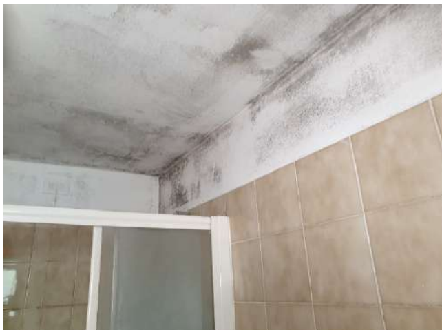
foto n. 7 – particolare soffitto bagno al P.T con muffe
