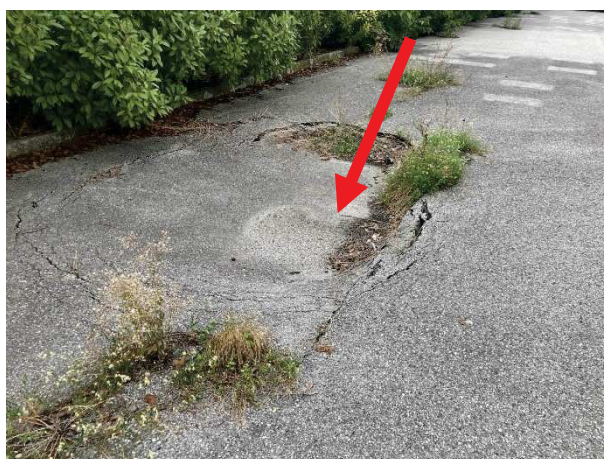
particolare degrado piazzale lato Ovest
