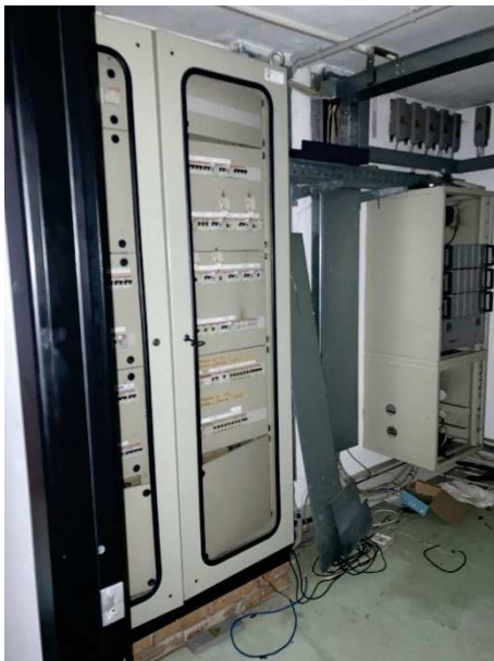
vista ripostiglio quadri elettrici al piano seminterrato
