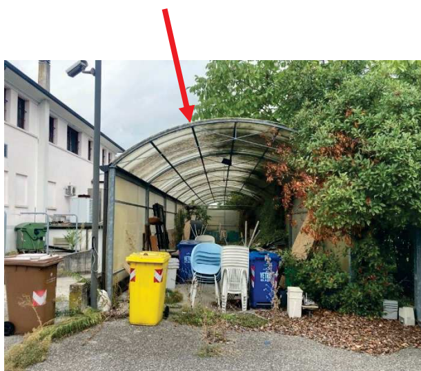
ulteriore particolare della tettoia abusiva lato Sud
