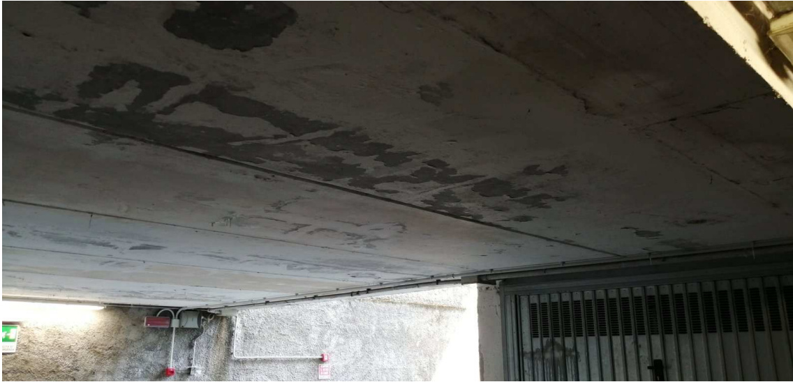
Infiltrazioni soffitto corsia comune garage
