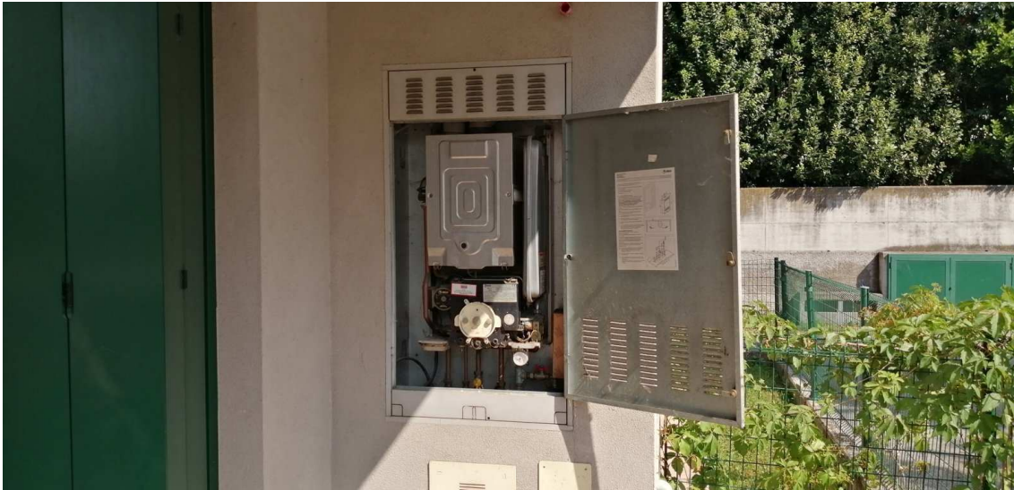
Caldaia autonoma gas metano
