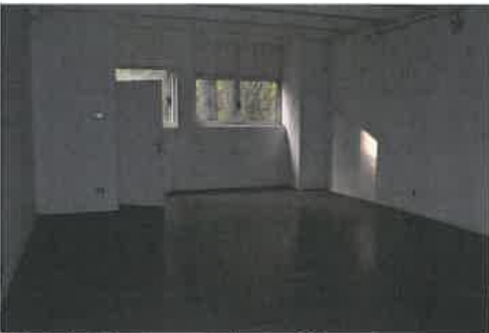
Uffici sub. 3 Piano terra con locale caldaia
