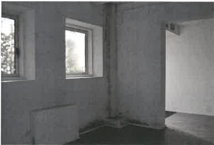
Ingresso uffici piano terra zona degrada per infiltrazione acqua
