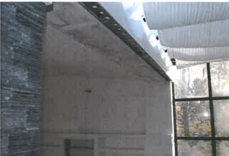
Interno sub. 4 parte centrale degradata per infiltrazione
