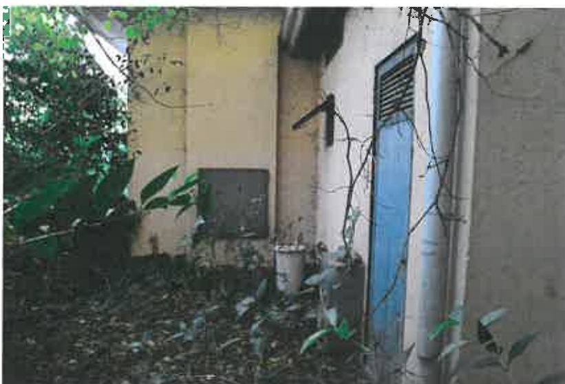
Centrale termica lato nord-ovest
